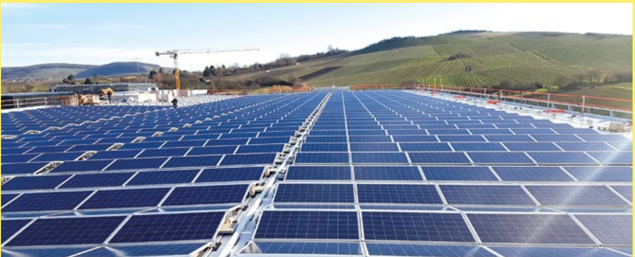
Parkhaus in Neckarsulm produziert Sonnenstrom: Das Dach ist vollständig mit Photovoltaik belegt. Knapp 2000 Module liefern eine Leistung von 520 kWp. Quelle: Orange Solar GmbH
