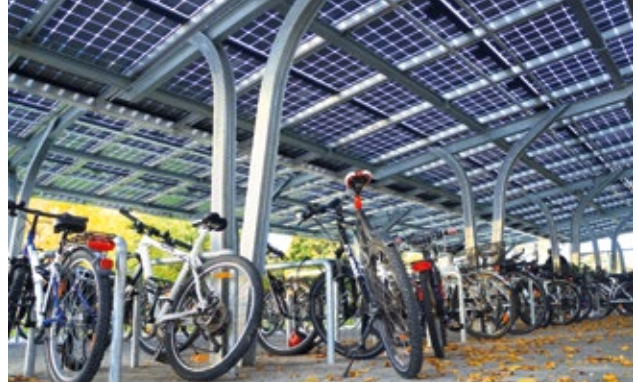
Doppelglas-Solarmodule eignen sich besonders für den Einsatz in Wintergärten, Carports oder anderen integrierten Solar-Lösungen wie hier bei einem Fahrrad-Unterstand, der gleichzeitig Strom erzeugt.
